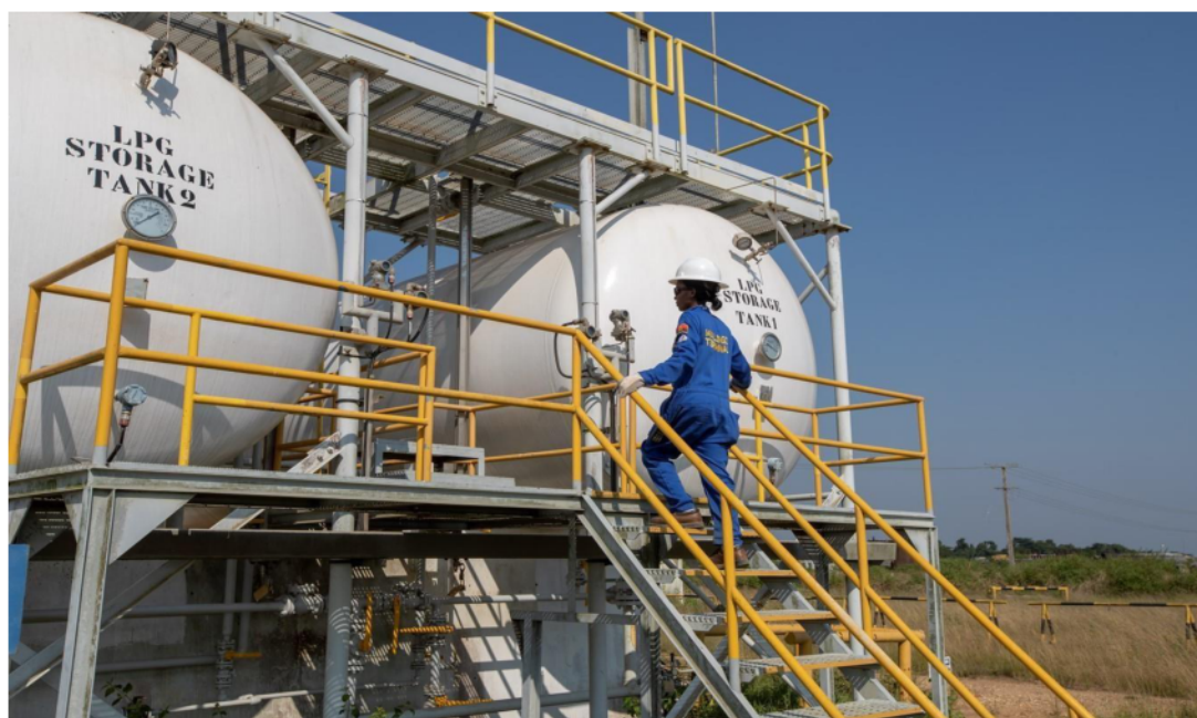
Figura 23 — Tanques de armazenagem de LPG (Terminal de Malongo — Cabinda)
