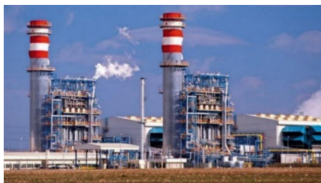
Figura 5 - Central Termoelétrica de Ciclo Combinando, no Soyo
