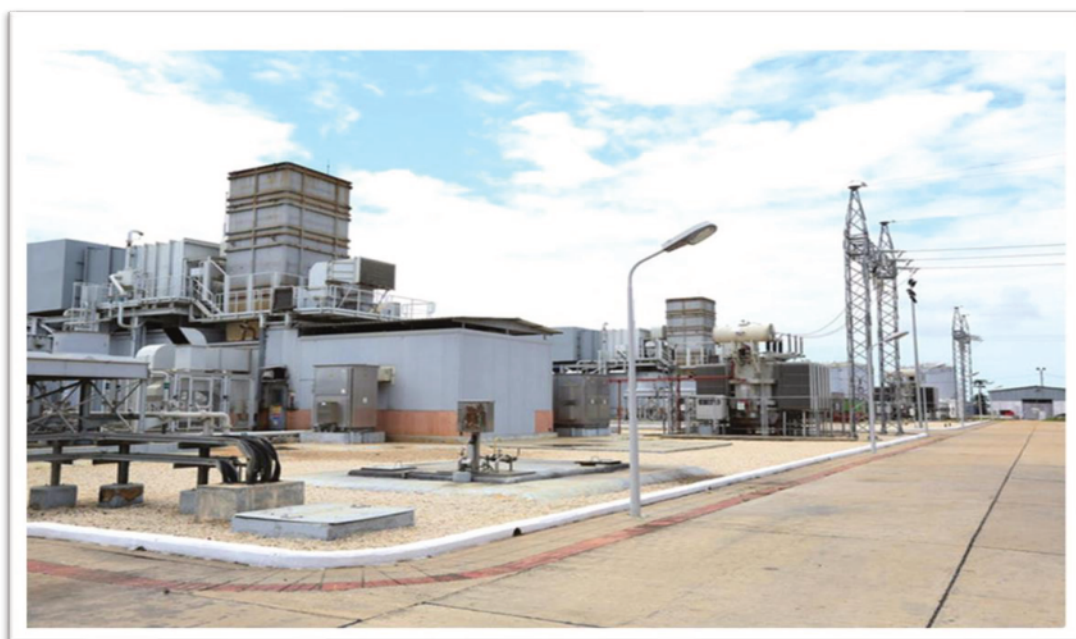
Figura 2 - Central Termoeléctrica do Malembo, Cabinda
